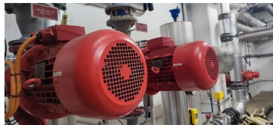
Pompes de distribution chauffage
