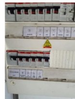
Etiquette sur disjoncteur de protection dans le TGBT
